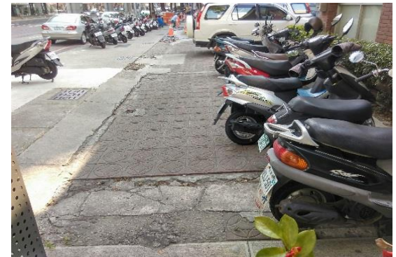
■鋪面破損改善前
