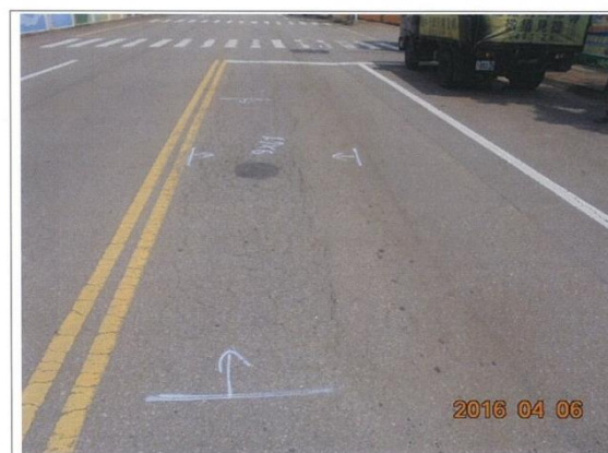
4/6 華山路兵營外牆旁(1) 路面裂痕下陷 建議尺寸 1.7X6
