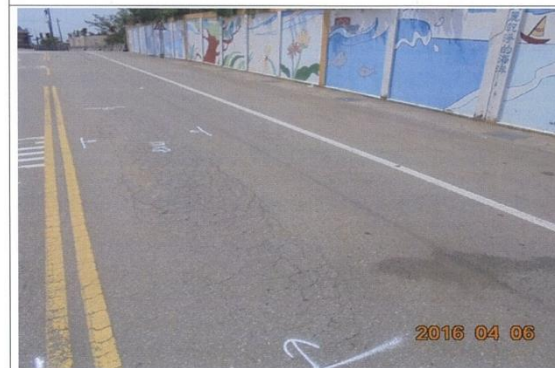
4/6 華山路兵營外牆旁(2) 路面裂痕下陷 建議尺寸 1.7X8
